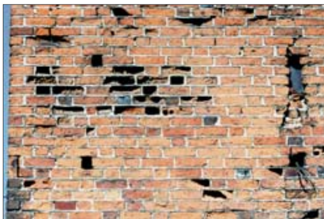
12. Baszta na odcinku nr 19 w południowo-zachodnim ciągu murów. Korozja cegły w licu ściany południowej wywołana zastosowaniem zbyt sztywnej spoiny. Fot. P. Tuliszewski, 2000 r.
